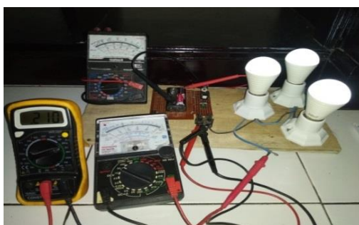
Gambar 2. Rancangan sistem inverter mini 1.5 V dc to 220 V ac dengan trafo Joule Thief
