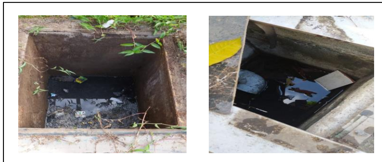
Gambar 3 Kondisi Inlet dan Outlet IPAL Komunal Desa Dutohe Barat
